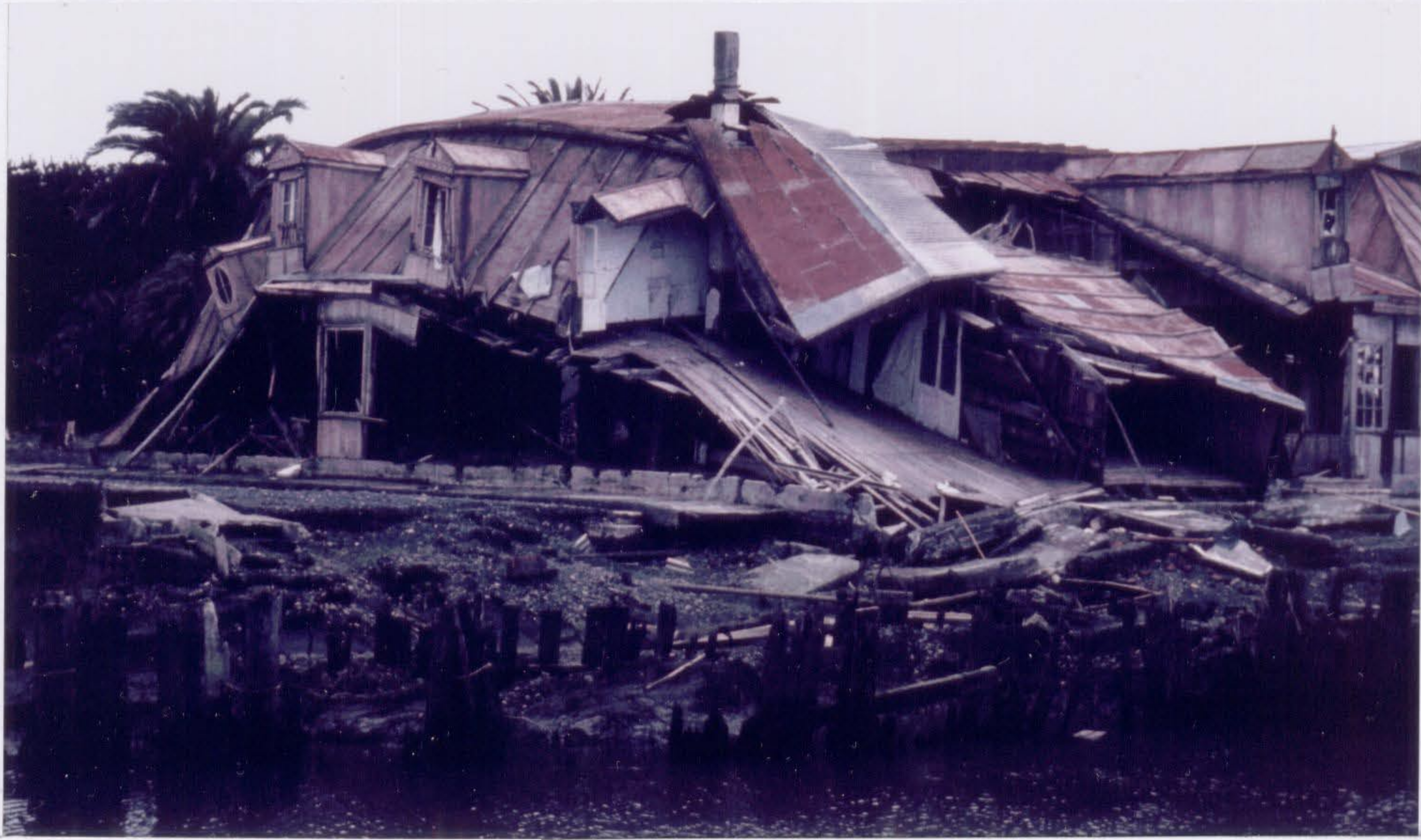
Ein vom Wasser völlig zerstörtes Gebäude in Puerto Saavedra.
